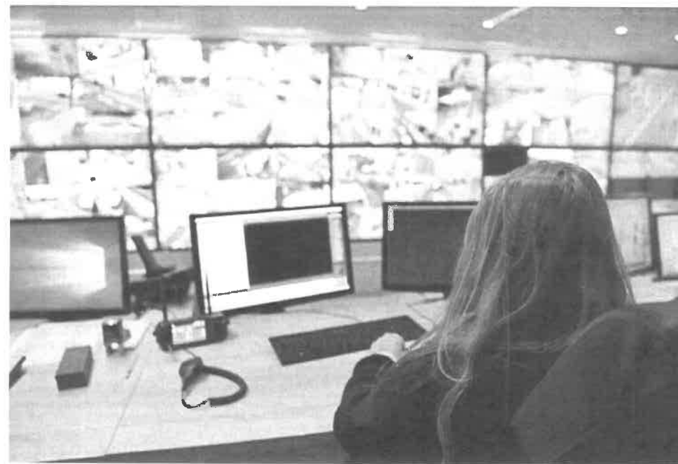
Le centre de supervision Intercommunal
